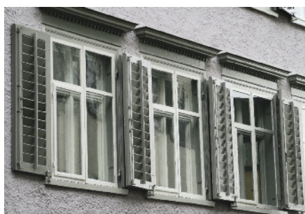
Historismus-Fenster mit der typischen Einfassung und Verdachung sowie mit restaurierten Vorfenstern und Läden mit beweglichen Jalousiebrettchen.
