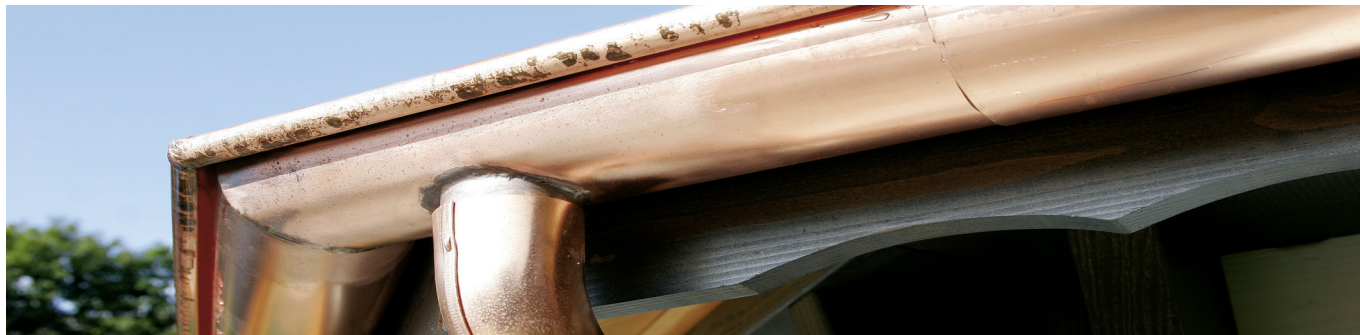
Grossflächige Kupferinstallationen können zu Grenzwertüberschreitungen im Gewässer führen
