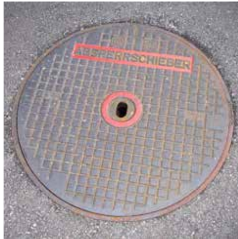
Beschrifteter Schieberschacht im Aussenbereich
