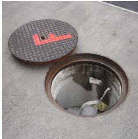
Kennzeichnung Schieberschacht für Ereigniskräfte
