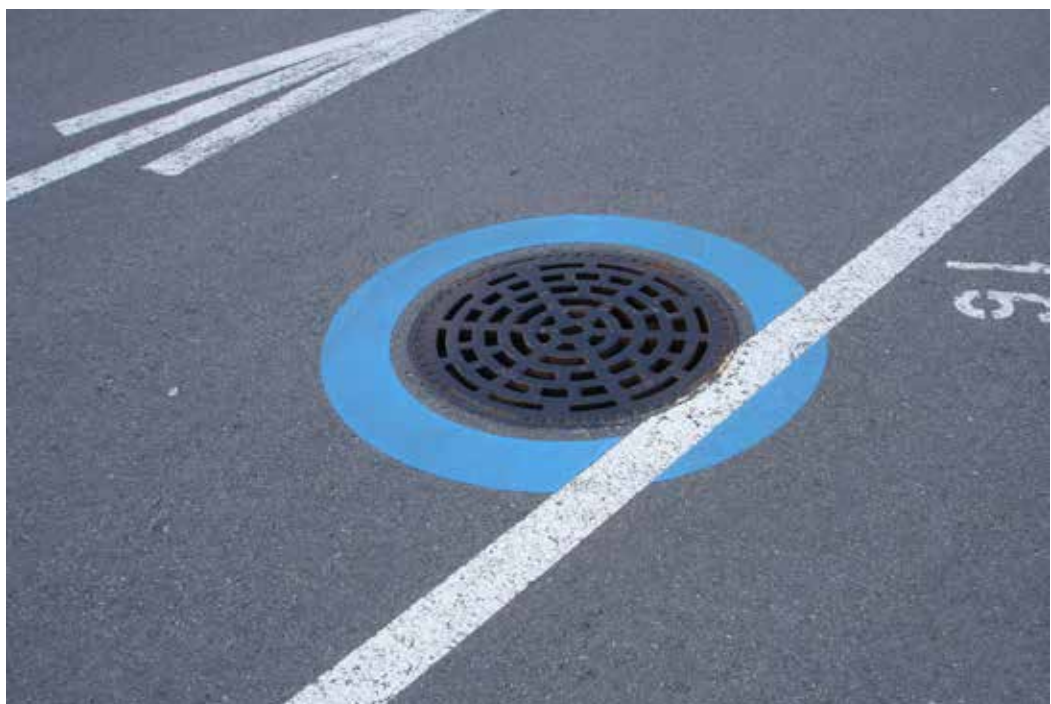
Kennzeichnung Meteorwasserschacht für Ereigniskräfte
