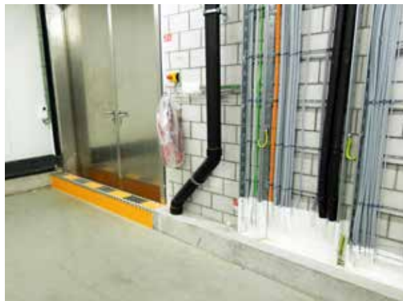
Schwelle und Absicherung von Fallsträngen
