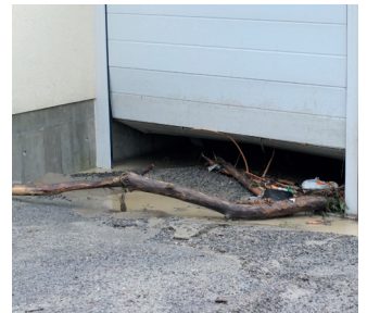
Altstätten, Hochwasser 2014 Eingedrücktes Tiefgaragentor
