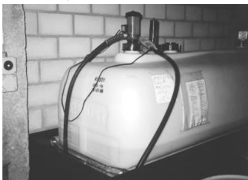
Kleintank mit elektrischer Pumpe
