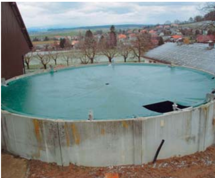
Abb. 6: Schwimmende Folie mit Schwimmern (System Arnold). Um das Auflösen von natürlichen Schwimmdecken bei Schwimmfolien zu verbessern wird die Folie beim Rühren mittels Seile aufgezogen.
