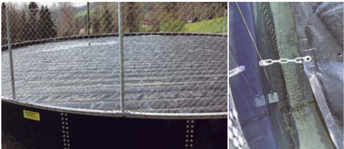
Abb. 5: Perforierte schwimmende Sandwichfolie (System Kohli). Die schwimmende Sandwichfolie ist am Behälterrand an vertikalen Seilen geführt.
