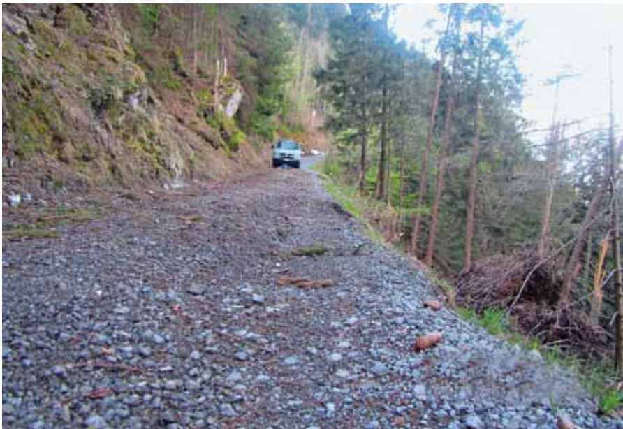
Setzungsschäden an einer Alpstrasse in Amden infolge des Sturms Burglind
