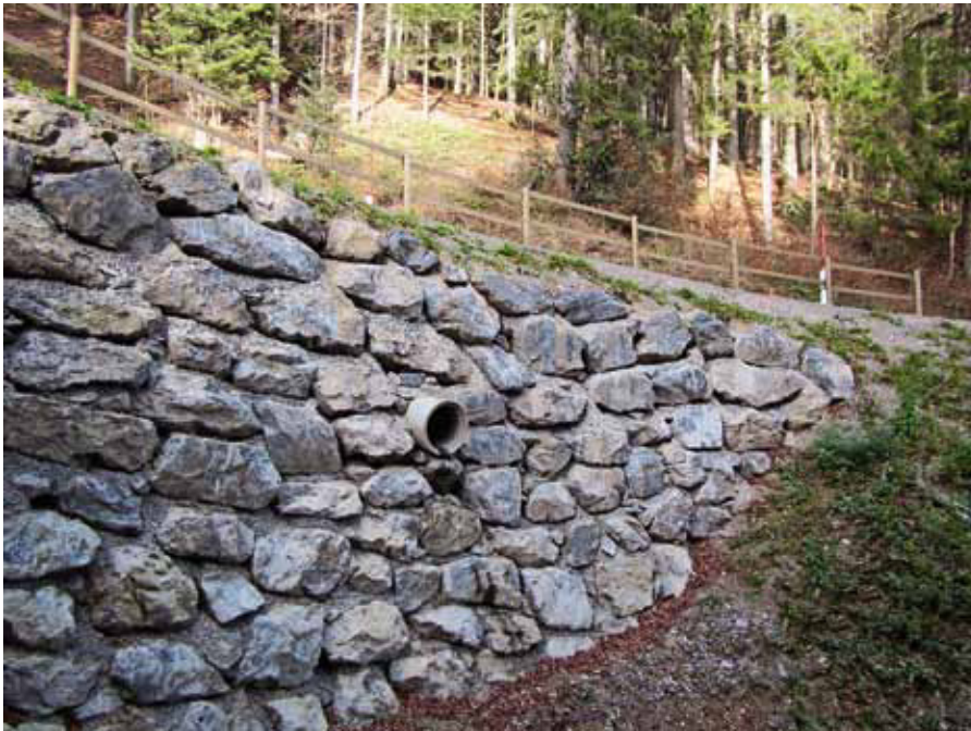
Altschwilerstrasse Krinau (Gemeinde Wattwil): Blocksteinmauer zur Sicherung der Strasse nach lokalem Rutsch
