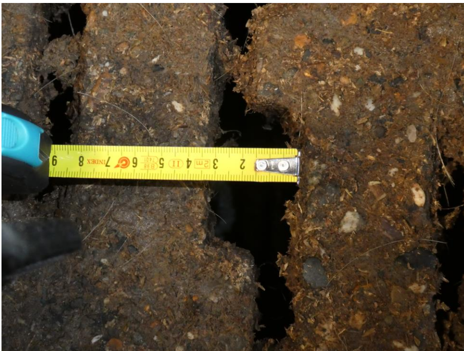
Zu grosse Spalten im Schweinestall als mögliche Verletzungsgefahr
