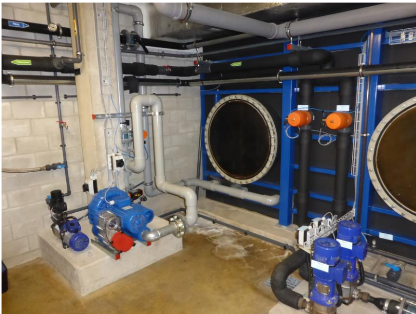
Im Rahmen von Bäderinspektionen wird immer auch hinter die Kulissen geblickt: Technikraum mit Wasseraufbereitungsanlage
