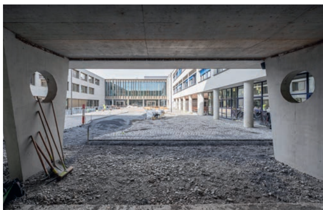
Christian Wenk mit Bauleiter Jonas Ambühl und Elektriker Nelson Gouveia von Equans (oben, von links). Das Provisorium wird weiterhin genutzt werden (Mitte). Blick durch den Zugang im Altbau über den Innenhof zum neuen Haupteingang (unten).
