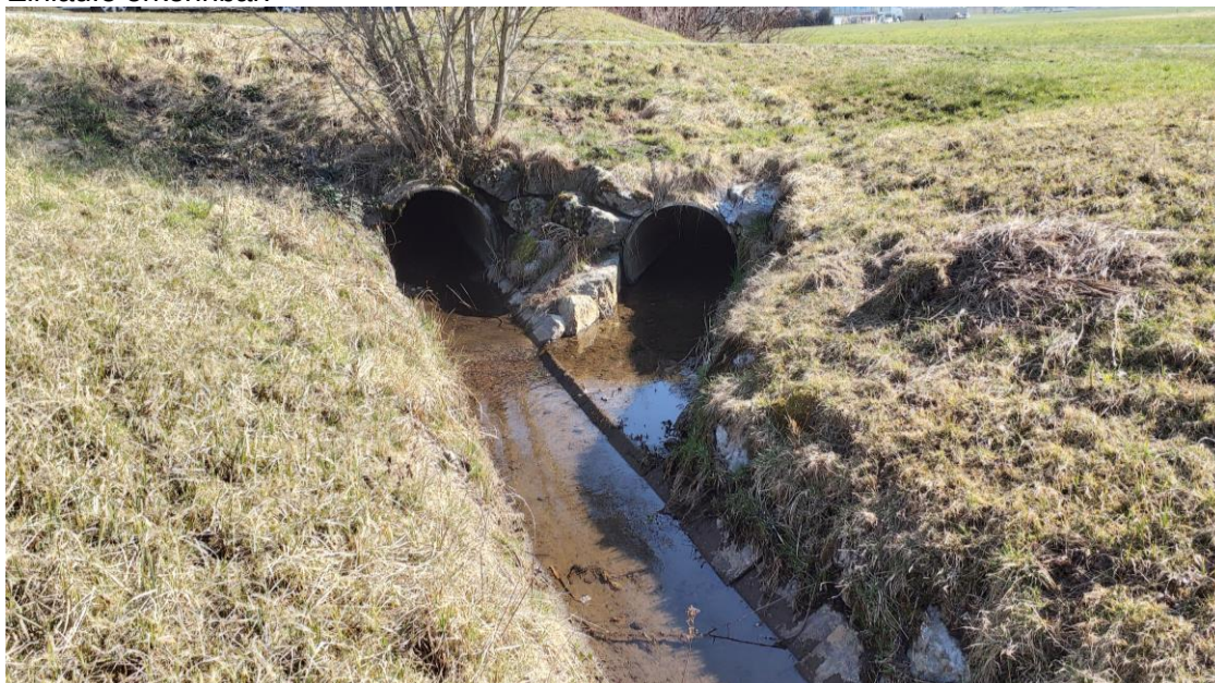
Abbildung 5: Einlauf der Strassenentwässerung (links) und Oberlauf des Witöfeligrabe (rechts). Blick gegen die Fliessrichtung. Sichtbar ist die harte Verbauung der Sohle mittels Betonplatten, erkennbar im rechten unteren Bereich.
