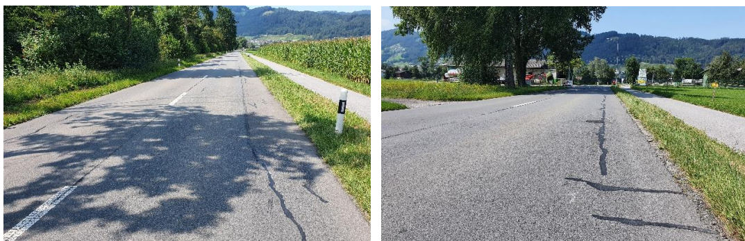
Abbildung 1 Klassische Schadensbilder mit Rissen entlang der Randbereiche (Foto 2021)
