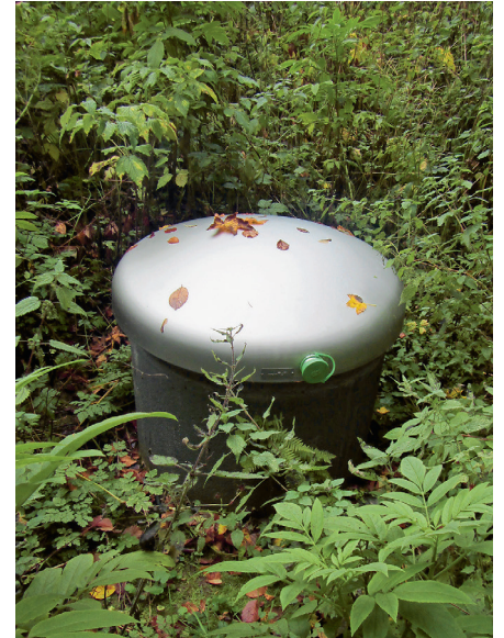
Alp Farner: neuer Quellschacht mit Domdeckel zur Sicherung der Wasserqualität
