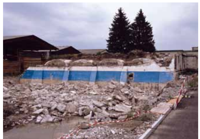
Filterhalle der St.Galler Stadtwerke in Goldach. Robert Maillarts innovative Betonkonstruktion nach hundert Jahren vom Bagger zerstört (Foto: kant. Dpfl).
