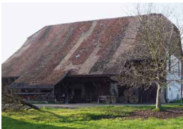
Rapperswil-Jona, Kloster Wurmsbach. Das Dach des Pferdestalls wurde 2004 unter Verwendung der alten Ziegel neu eingedeckt. (Foto: Kant. Denkmalpflege)
